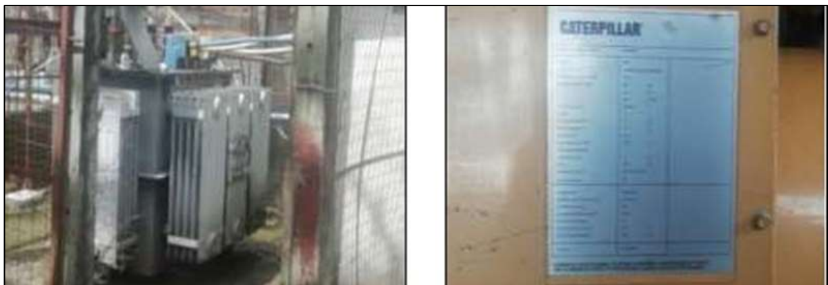
ပုံ ၄-၁၁ စက်ရုံတွင်း အသုံးပြုသည့် Transformer နှင့် Generator
