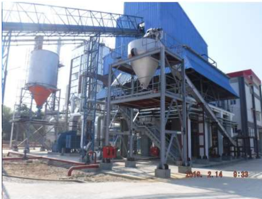
(g) Bottom Ash Silo
