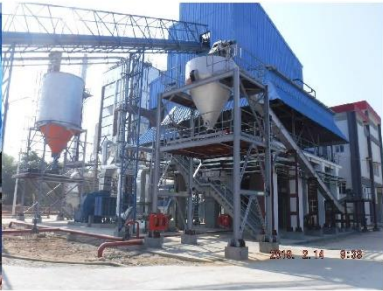
Bottom Ash Silo
