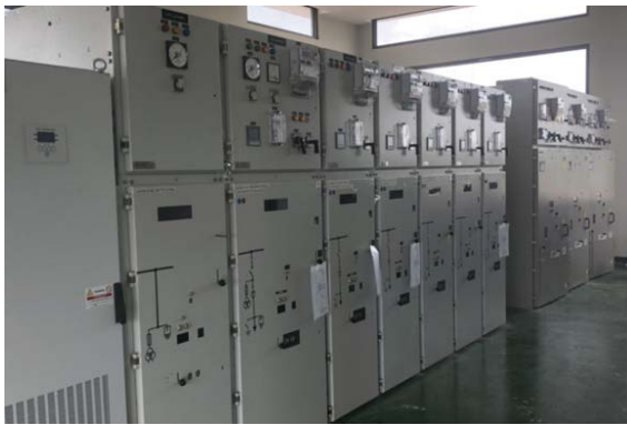
11kV Switchgear Panel_01
