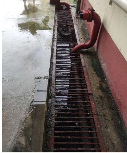
ပုံ(12) စက်ရုံဝင်းအတွင်းရှိ ရေနှုတ်မြောင်းတည်ဆောက်ထားရှိပုံ
