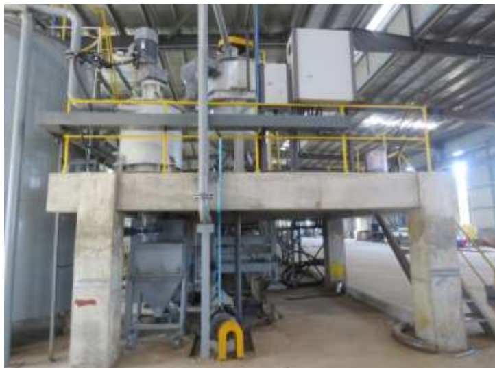
Figure-37: Slag separator
