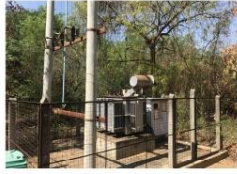
400 KVA Transformer တစ်လုံး
