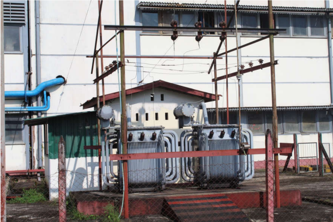
စက်ရုံအတွင်းရှိ Transformer များပုံ
